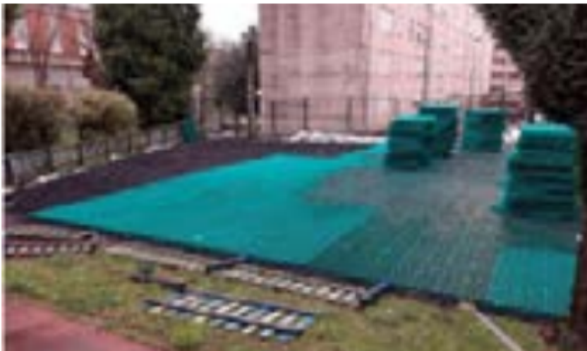
□ Plataforma drenaje sostenible SUDS, Atlantis Otxarkoaga (Bilbao)
